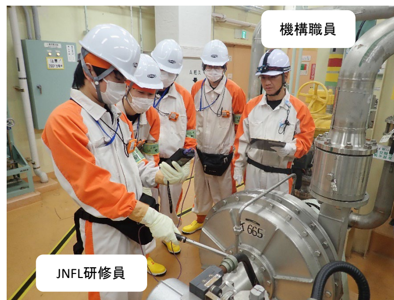
機構職員指導のもと、JNFL研修員による排風機の点検
