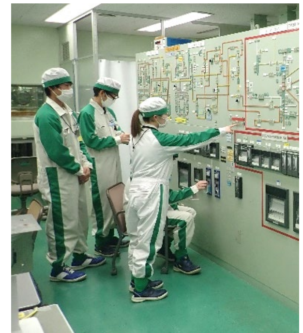
操作パネルにおける運転操作
